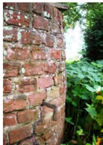
Een duim in de putwand van een waterput in Zemst om de putstok beneden te houden. (Foto Mot.)
